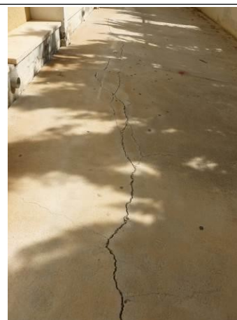
Zona 3 Vista detallada de grieta y hundimiento de pavimento
