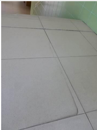
Ala Sur, hundimiento del cajón de escalera
