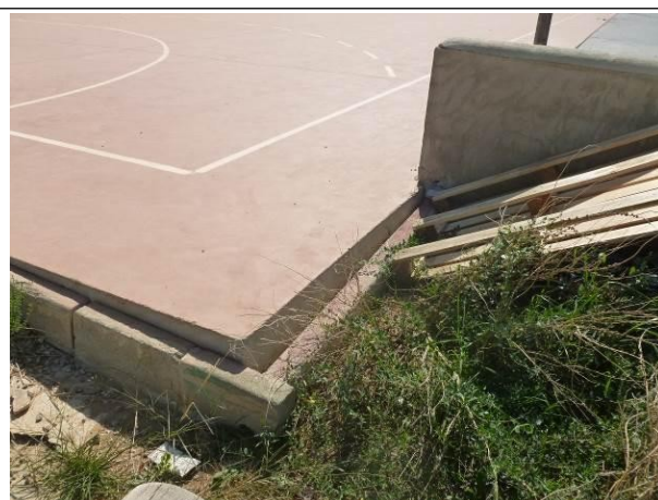
Zona 1 deslizamiento en borde de pistas
