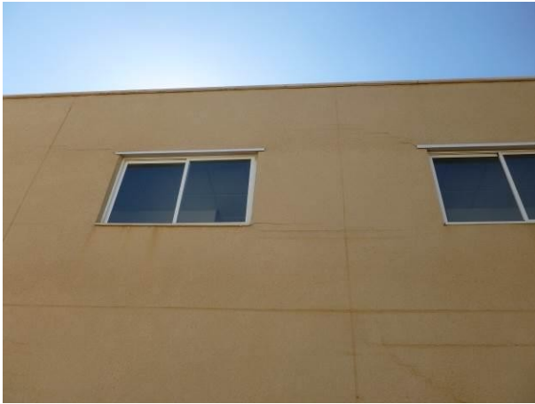
Ala Central, vista de agrietamientos
