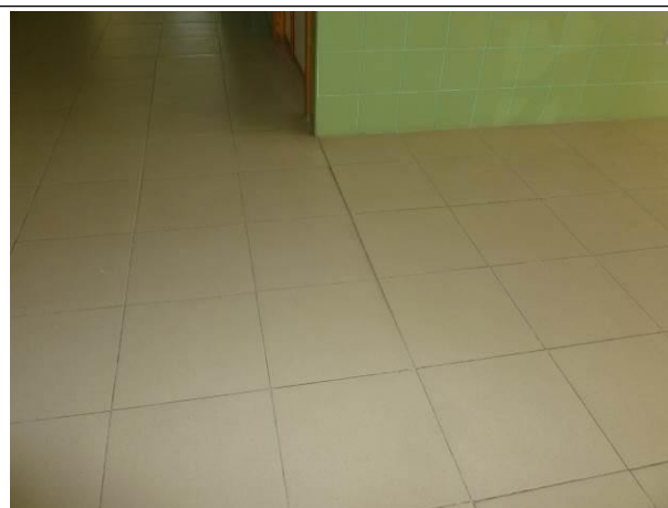
Distribuidor, hundimiento de pavimento y apertura de grietas
