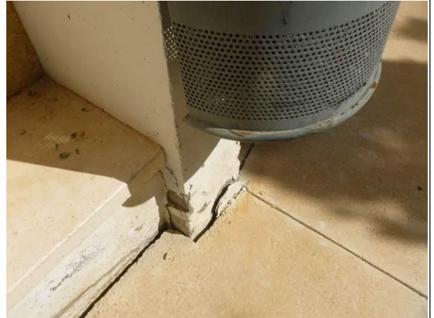
Zona 3 vista de desconchón en pilar diferente.
