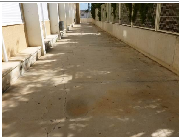
Zona 3 Vista de grieta y hundimiento de pavimento
