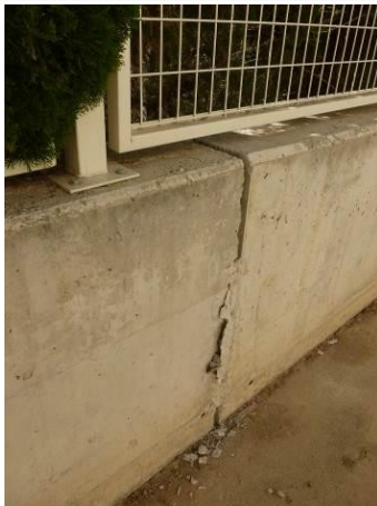
Zona 3 reventón de muro
