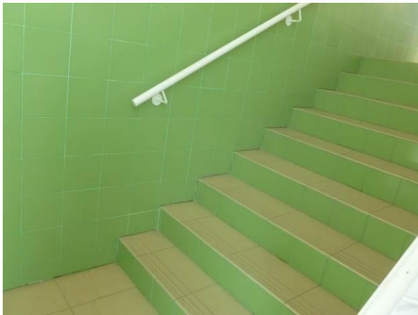
Ala Sur, hundimiento de cajón de escalera
