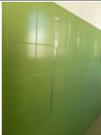
Ala Central, azulejos despegados
