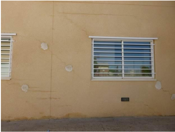
Ala Central, vista de agrietamientos y testigos
