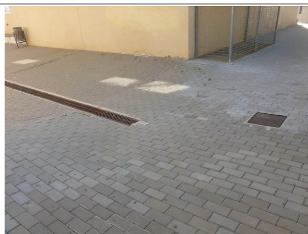
Zona 2 hundimientos de pavimento
