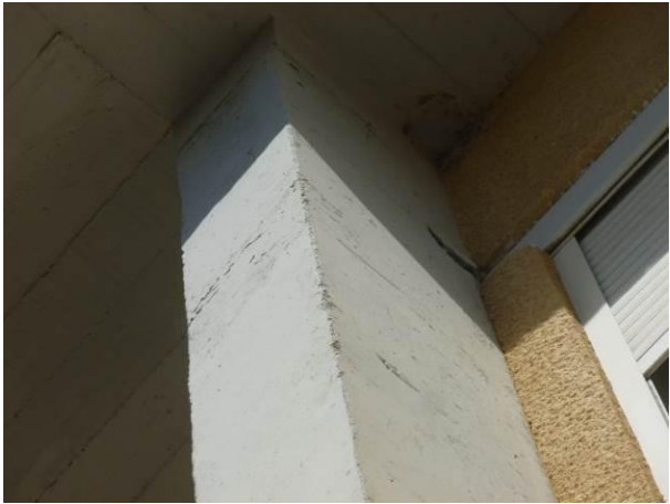
Ala Central, vista de daños en pilar en encuentro con dintel
