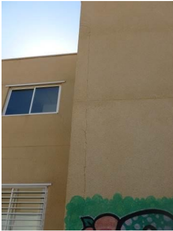
Ala Central, vista de agrietamiento
