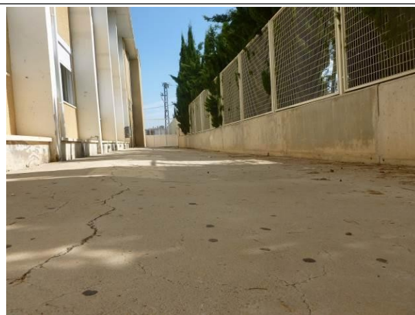
Zona 3 Vista del muro y hundimiento de pavimento
