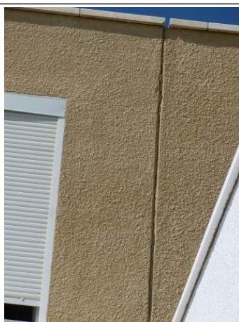
Zona 5 apertura de junta de dilatación en fachada
