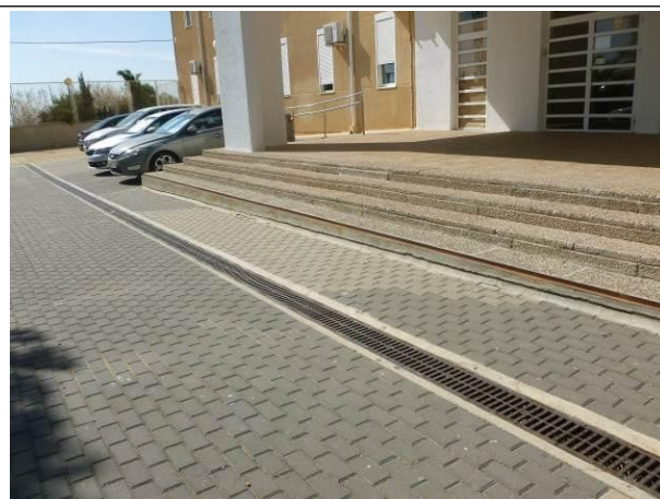
Zona 5 vista de hundimiento del pavimento en la entrada
