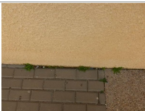
Zona 2 falta de zócalo y crecimiento de vegetación
