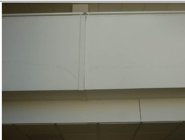
Distribuidor, apertura de grieta y paramento
