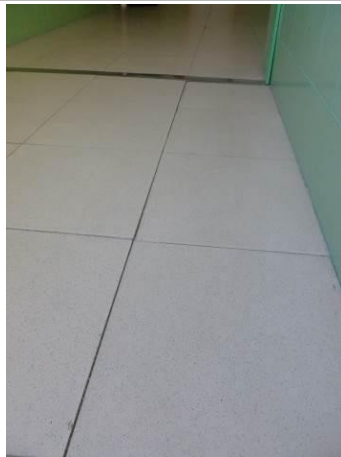
Ala Central, vista de junta abierta en pasillo
