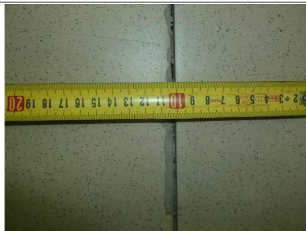
Ala Central, movimiento de pavimento en aulas
