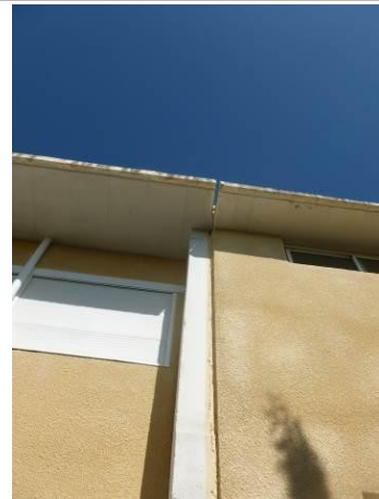
Zona 3 apertura de junta de dilatación en fachada
