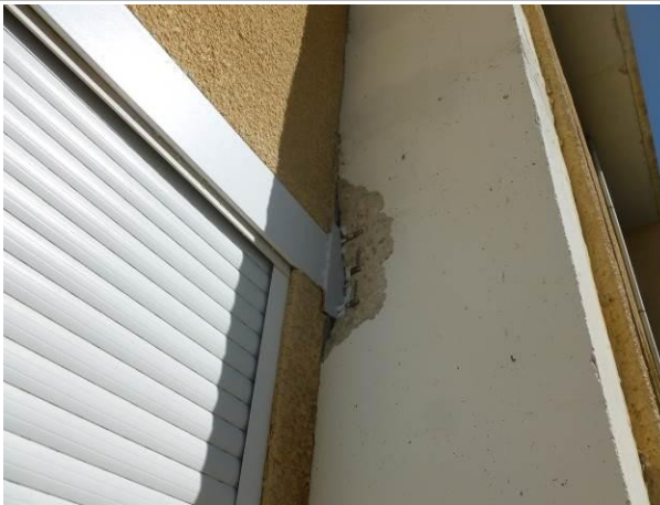
Zona 3 rotura de pilar con dintel en fachada
