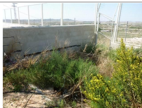
Zona 1 Rotura de valla de contención.
