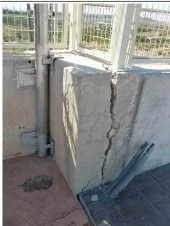
Zona 1 grieta en muro zona sur
