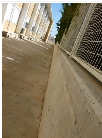
Zona 3 Pandeo de muro
