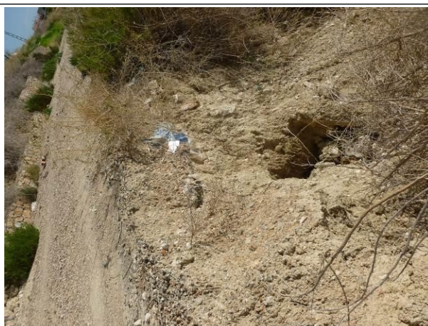
Zona 4 Vista de Sifón 2
