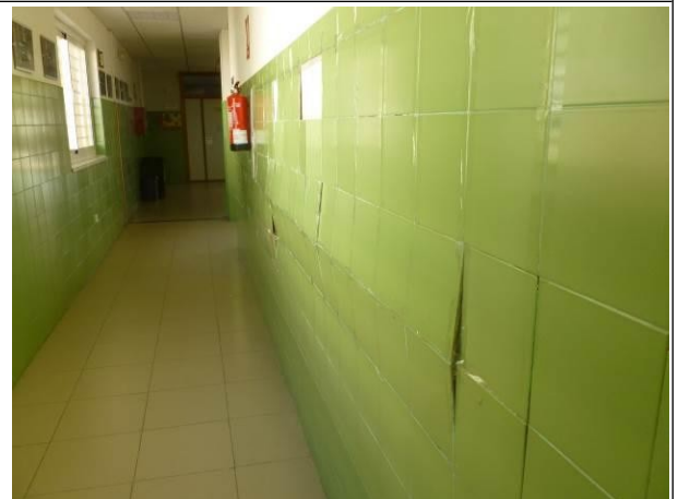
Ala Central, azulejos despegados
