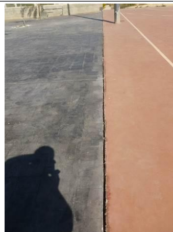
Zona 1 Apertura entre hormigón impreso y pistas
