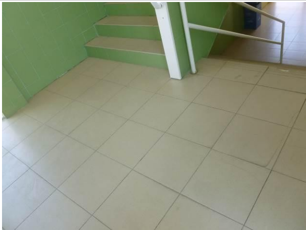
Ala Sur, hundimiento de cajón de escalera
