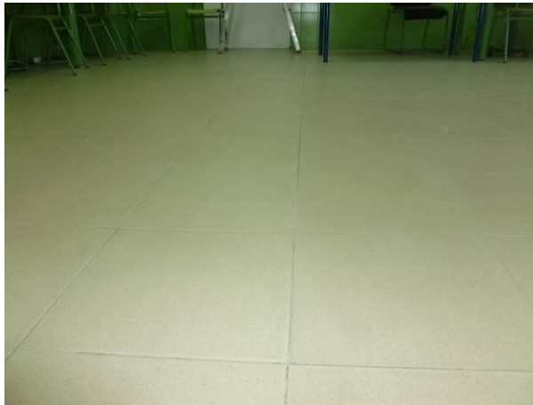
Ala Central, vista de junta abierta en aula
