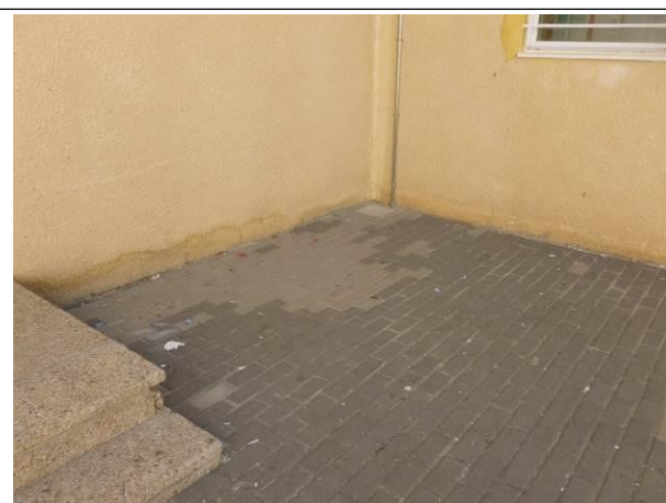
Zona 2 humedades en base y falta de zócalo
