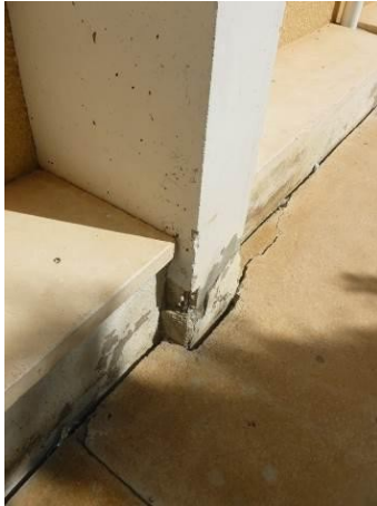
Zona 3 vista de armadura vista en pilar y desconchón
