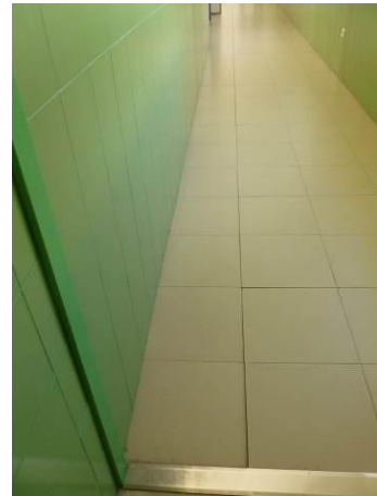
Ala Central, vista de apertura de pavimento y desplome
