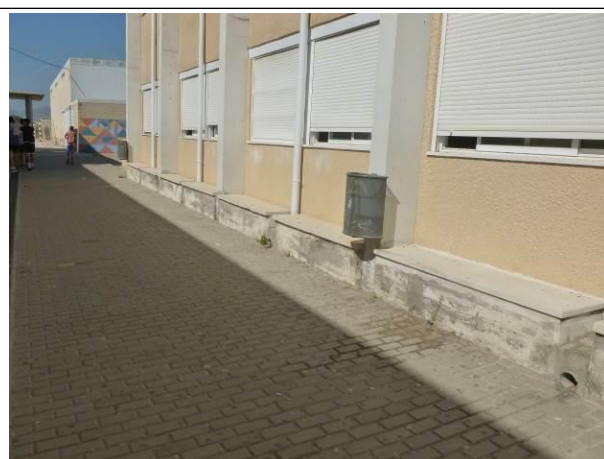
Zona 2 humedades en base y falta de zócalo
