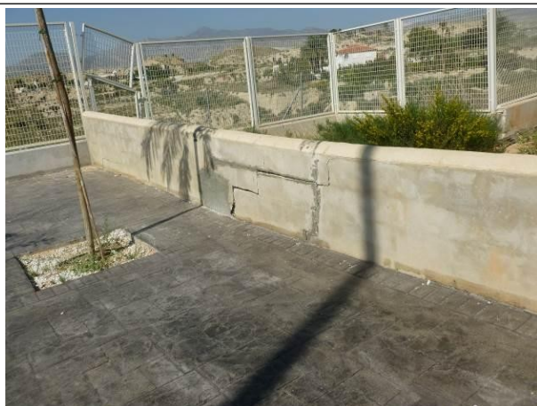
Zona 1 rotura de muro de contención
